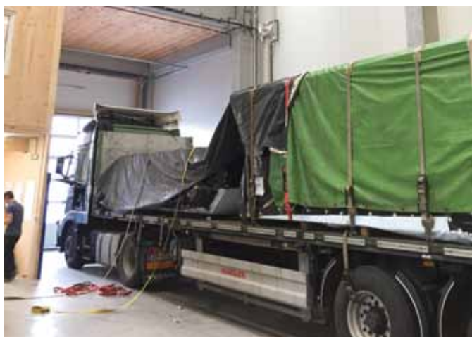
ABB. 3. Vorgefertigte Bauteile können mittels Lkw direkt in die Halle angeliefert werden. Diese werden dann mit den vorhandenen Hallenkränen entladen und im Optimalfall direkt in die Prüfraumen aus Stahlbeton eingebracht.
